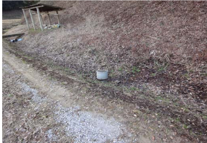
写真 5-1(4) 暗渠タイプのキャッチ水路
